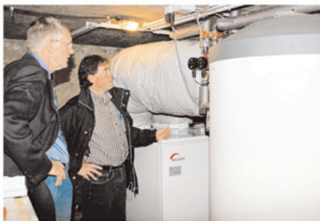
Eine Luft-Wasser-Wärmepumpe sorgt jetzt im Keller des Wohn- und Geschäftshauses von Gerhard Budke (li.) für preiswerte, umweltschonende Wärme. Matthias Upmeyer (Upmeyer Haustechnik) rät zu der neuen Heiztechnologie.
